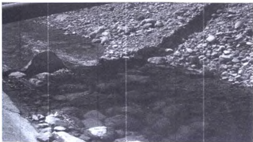
5.11 – rasm. Togʻ yon-bagʻridan oʻtgan kanal oʻzanini tosh bosishi holati.
